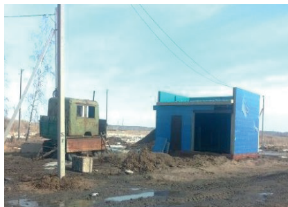
Недостроенная насосная станция в с. Ильичевка
